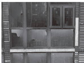
图 10 正立面饰面砖脱落
