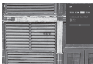
图 13 饰面砖脱落面积测量
