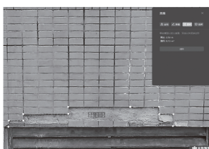
图 12 饰面砖脱落面积测量
