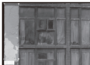
图 11 饰面砖脱落面积测量
