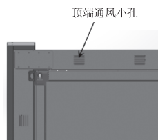
图 2 箱式变电站顶端侧边缘通风孔
